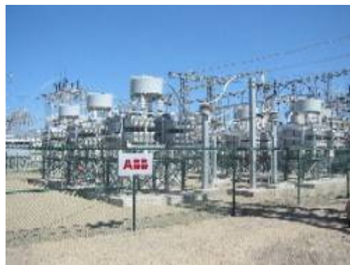
Abbildung 2-14 SVC in Newark, USA (Quelle: ABB)
