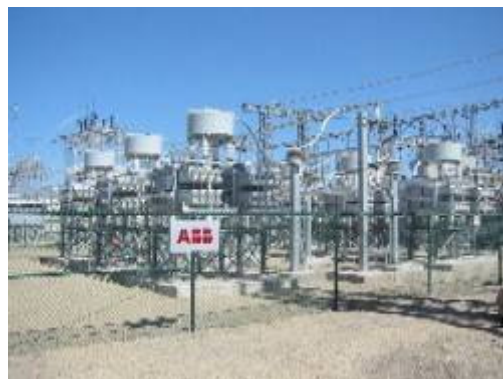
Abbildung 2-14 SVC in Newark, USA (Quelle: ABB)
