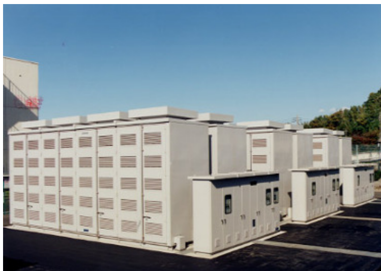
Abbildung 2-13 NaS-Batterien ( 3 \times 2 \text{ MW}_{\text{el}} ) zur Belastungsverteilung von drei Banken (Quelle: IERE, Japan)
