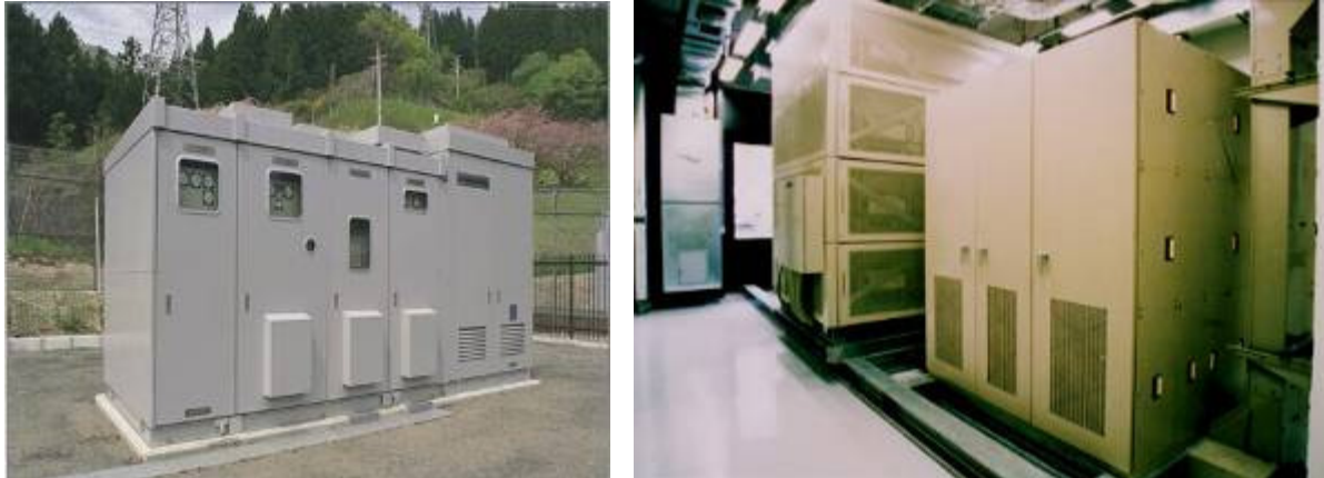
Abbildung 2-9 NaS-Batterie in Kinugawa und im TEPCO R&D Center (Quelle: IERE, Japan)
