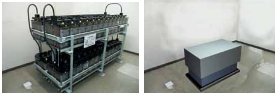
Abbildung 2-3 Unterschied Platzbedarf zwischen Blei-Batterie und NaS-Batterie (Quelle: IERE, Japan)
