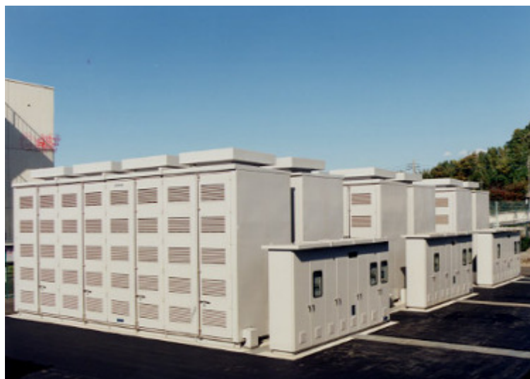
Abbildung 2-13 NaS-Batterien ( 3 \times 2 \text{ MW}_{el} ) zur Belastungsverteilung von drei Banken (Quelle: IERE, Japan)
